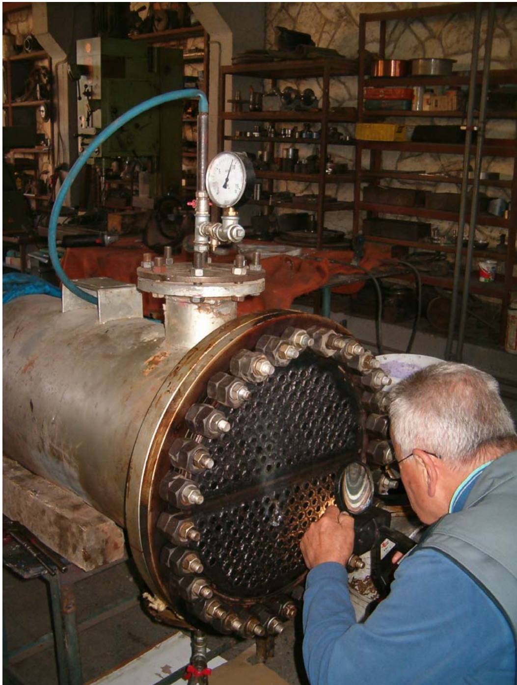
Slika br. 8 Detaljni pregled cevne ploče lupom posle produženog ispitivanja na HVP
