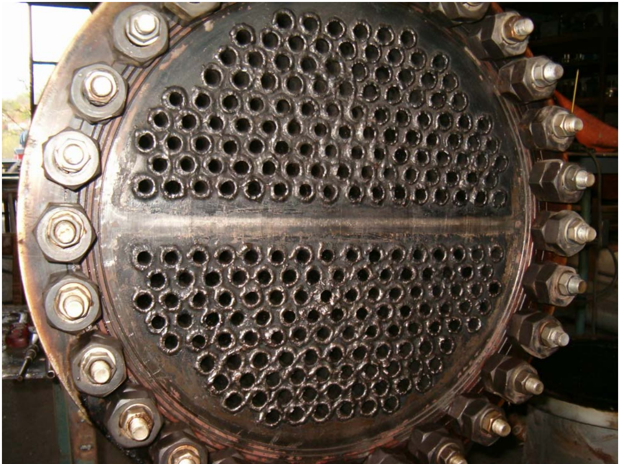
Slika br. 5 Izgled cevne ploče, posle mehaničkog čišćenja i pranja naftom i benzinom
