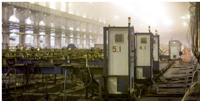
Slika 5: Velika jamska peć za pečenje ugljenih elektroda za potrebe elektrolitičkog procesa dobijanja aluminijuma
